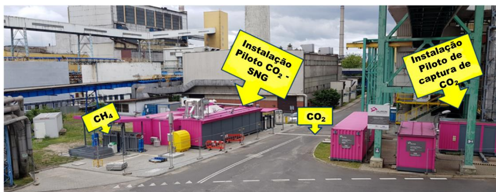
Figura 6 – Instalação piloto na central elétrica de Łaziska, Polónia (SNG – substitute natural gas). [adaptado [55]]
